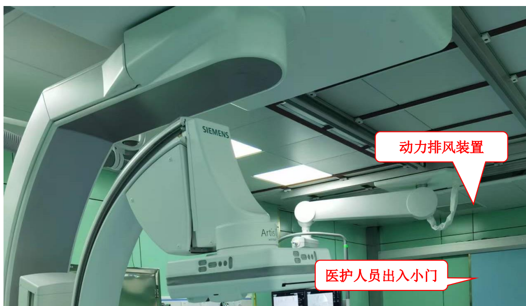
图 3-5 安装在 2#DSA 机房吊顶内的动力排风装置
